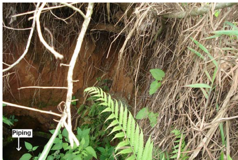
Figura 2. 7 – Erosão interna "piping" (Bananal, SP).
