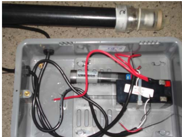
Figura 3. 32 - Caixa impermeável com "data logger" e bateria.
